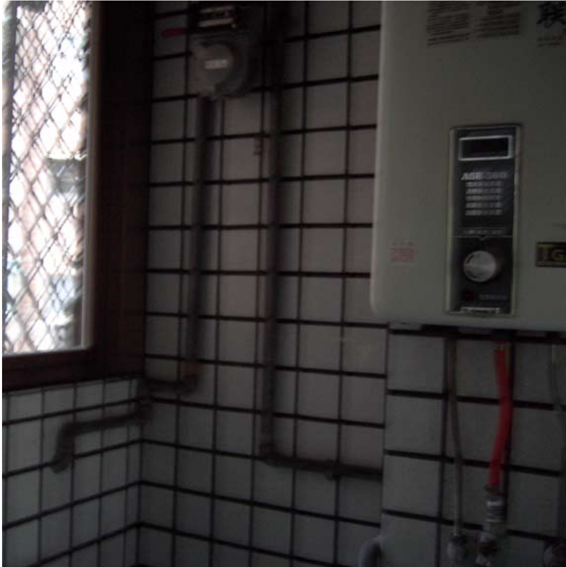
陽台圍起等於室內，熱水器擺放於此，住戶危險性大增
